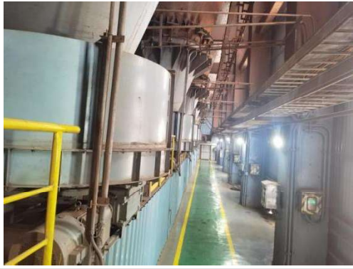
西区烧结配料室
