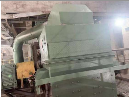
混_2 皮带落料点
