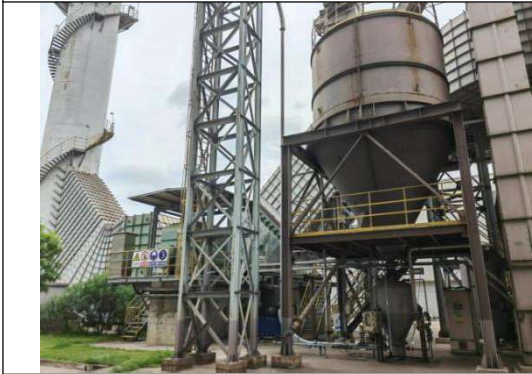
C4 除尘系统除尘器除尘灰仓
